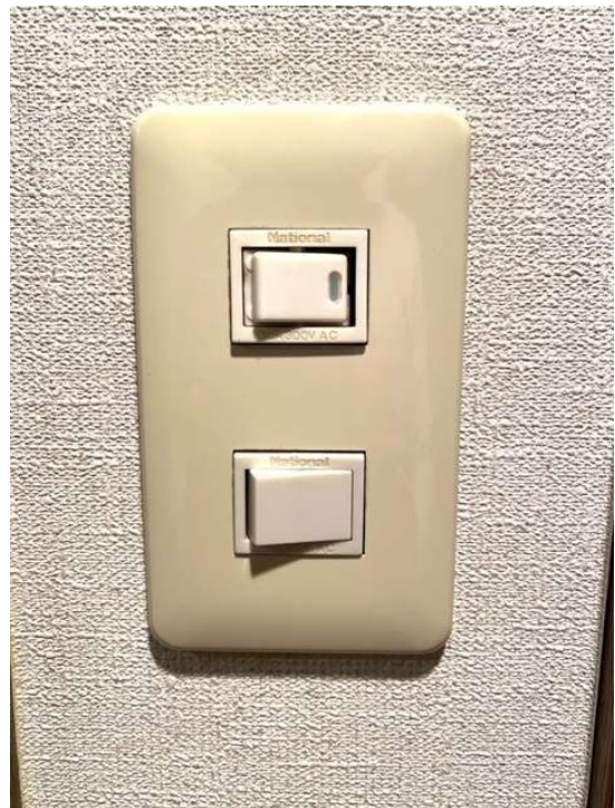
【写真4】壁スイッチ（トイレ） → 交換希望
