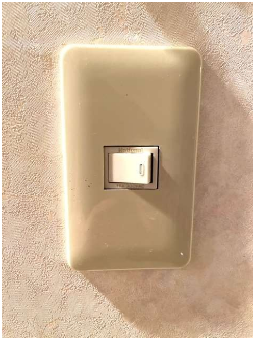
【写真1】点かない壁スイッチ（洗面台）
