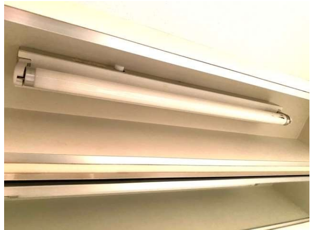
【写真2】点かない蛍光灯（洗面台）
